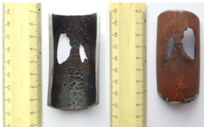
Рис. 1. Характерный вид повреждения трубопровода испарителя низкого давления в зоне отвода [1]
